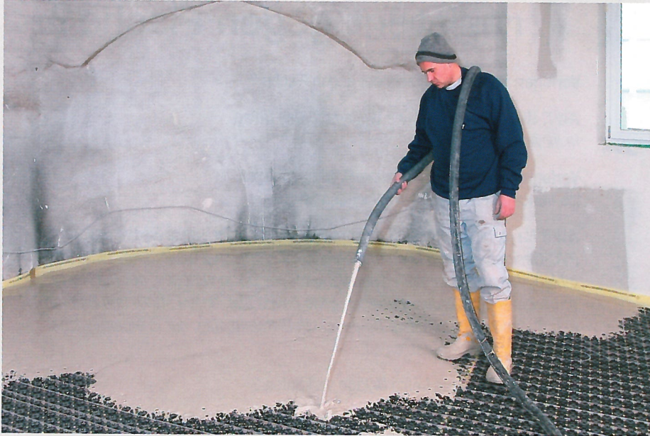
Die Heizschlangen der Fußbodenheizung sind verlegt, der Fließestrich wird eingebaut, später folgt das Funktions- und das Belegreifheizen.
